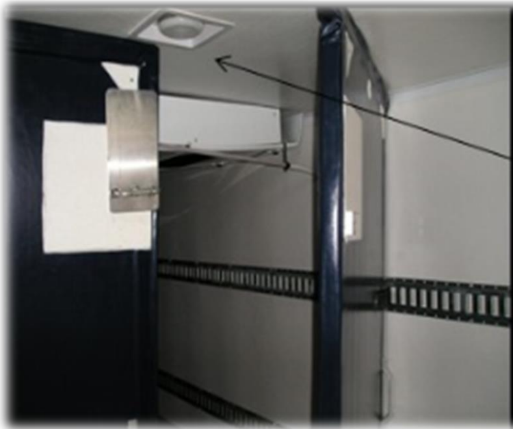
CHAROLA EMPOTRADA EN TECHO PARA PLAFON DE LUZ.
